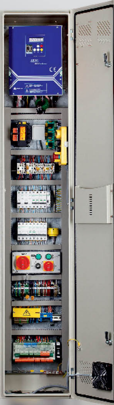
Dişisiz Pano Gearless Control Panel
