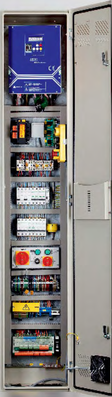
Dişisiz Pano Gearless Control Panel
